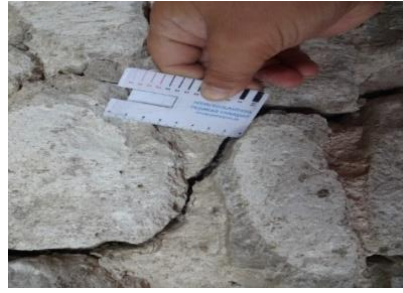
Şək. 5. Çatlarda eninin təyin olunması
