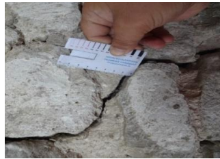
Şək. 5. Çatların eninin təyin olunması
