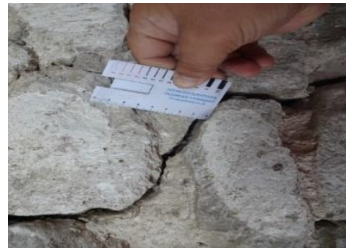
Şək. 5. Çatlارın eninin təyin olunması
