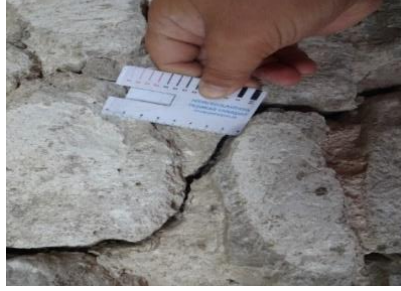
Şək. 5. Çatlara eninin təyin olunması
